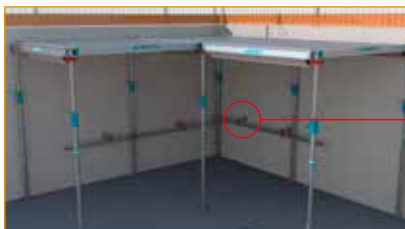
- Mettre en place la stabilisation des premiers éléments. - Une fois la stabilisation en place, il est possible de retirer les trépieds.
