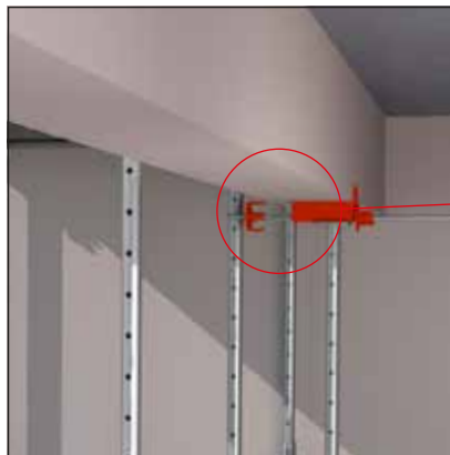
- Mettre en place la stabilisation des premiers éléments. - Lorsqu'elle est en place, il est possible de retirer les trépieds.
